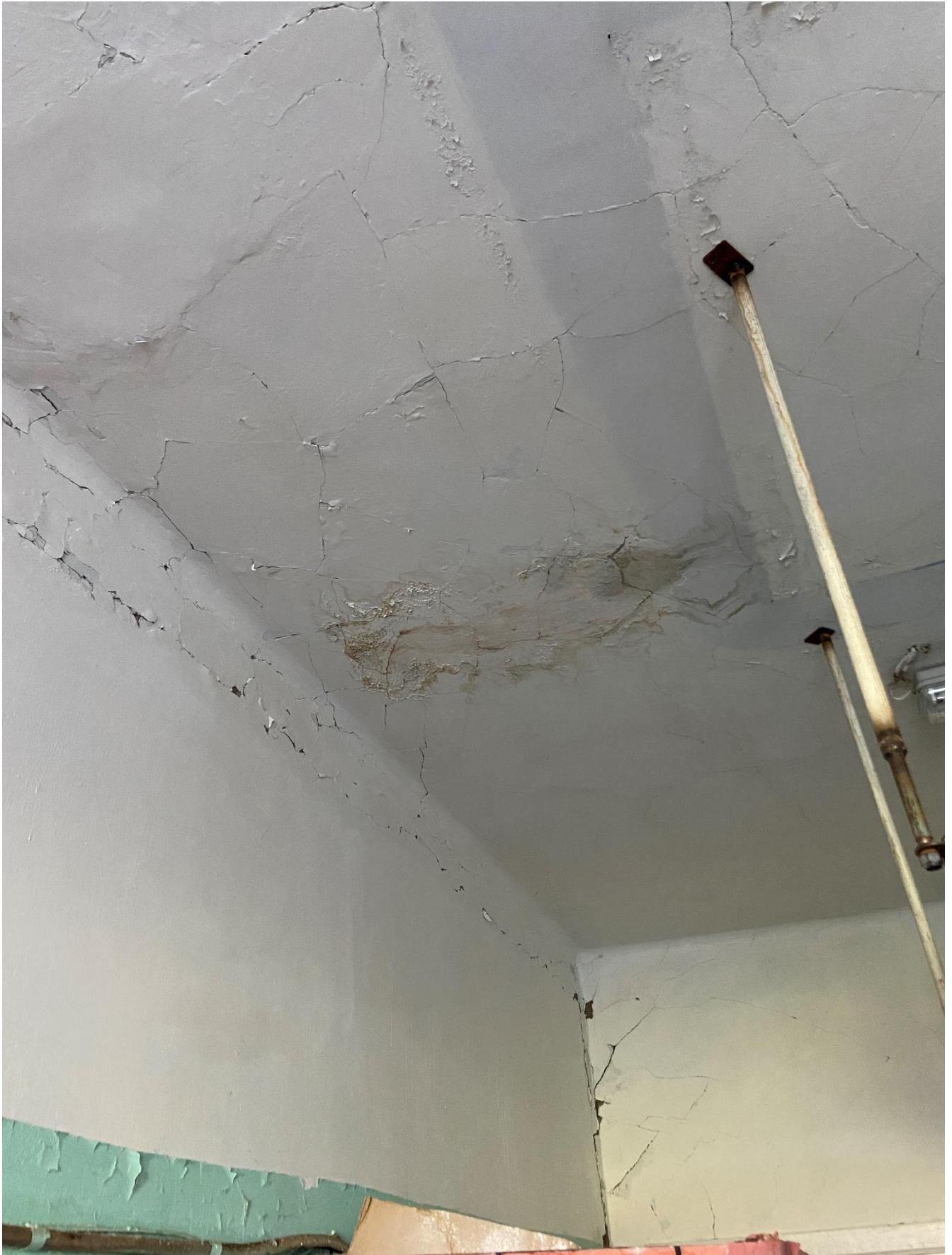
Изображение 33. Образование сети трещин по штукатурному слою стен и перекрытия, следы протечек
