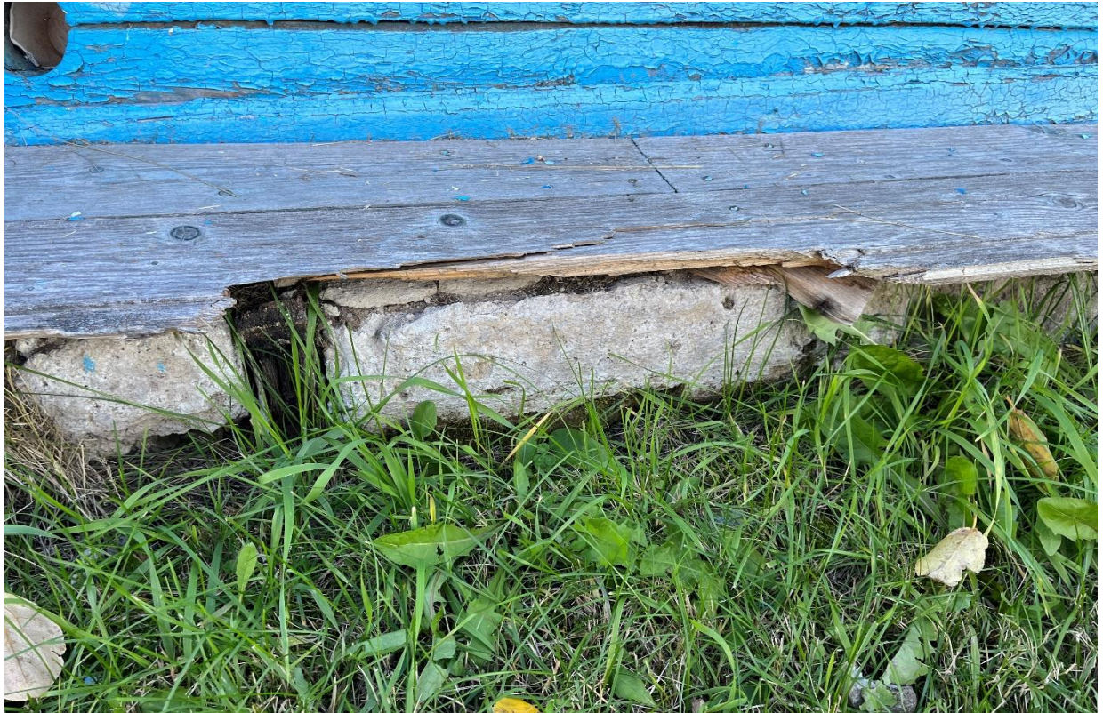
Изображение 13. Разрушение цоколя здания
