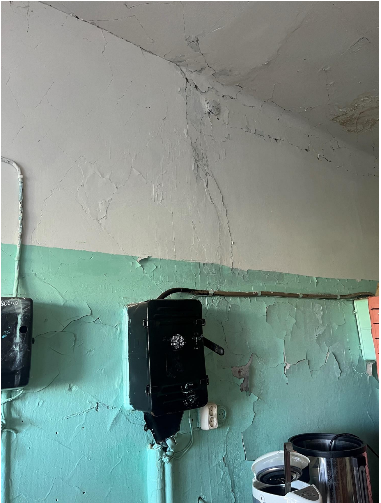
Изображение 26. Образование сети трещин по штукатурному слою стен и перекрытия, следы протечек
