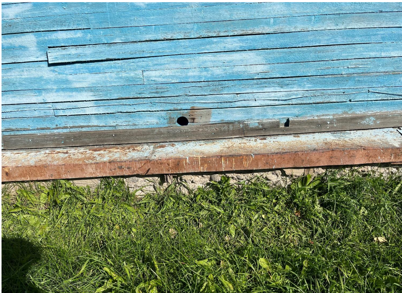
Изображение 19. Деформация наружной дощатой обшивки здания
