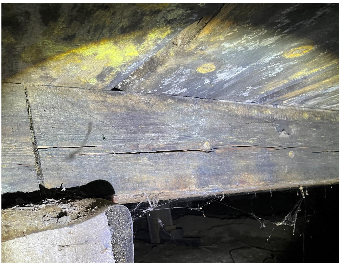
Изображение 24. Образование продольных трещин по ростверку фундамента
