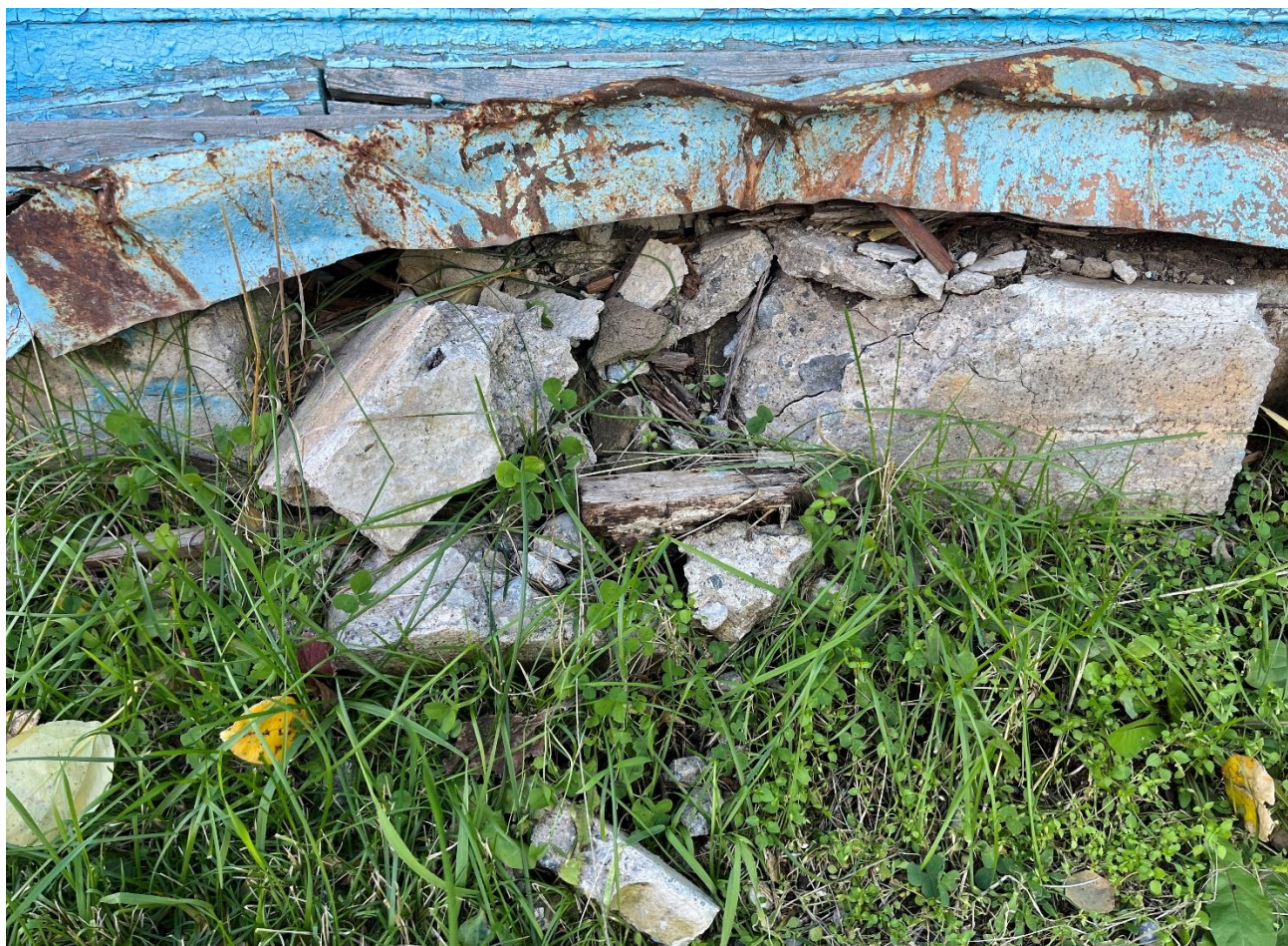
Изображение 12. Разрушение цоколя здания
