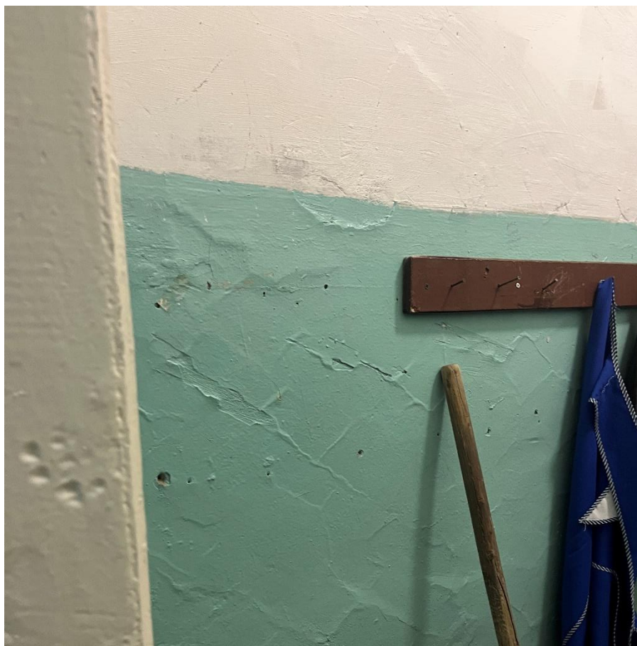
Изображение 28. Образование сети трещин по штукатурному слою
