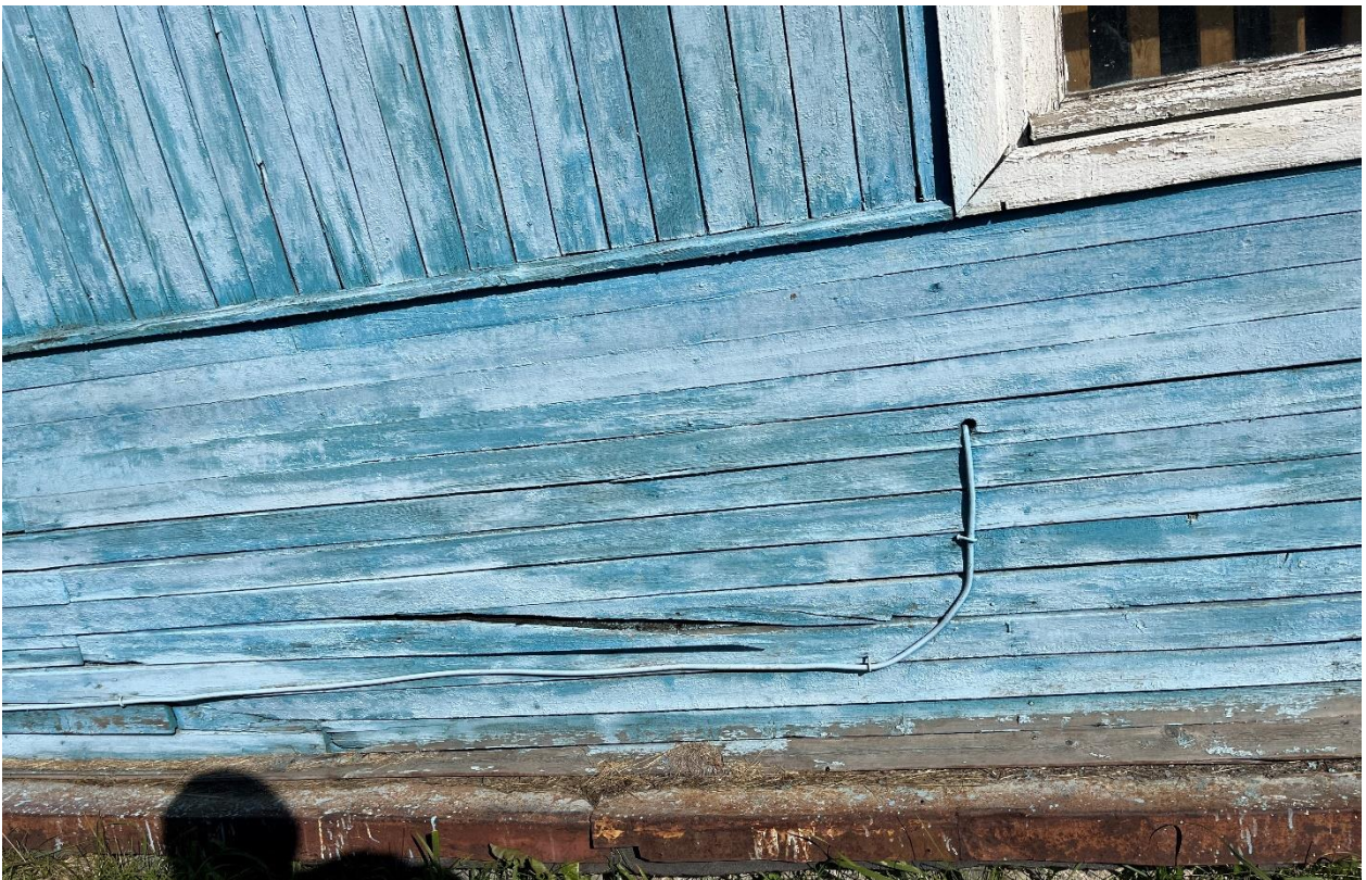
Изображение 18. Оголение гидроизоляции стен из-за местного выпучивания
