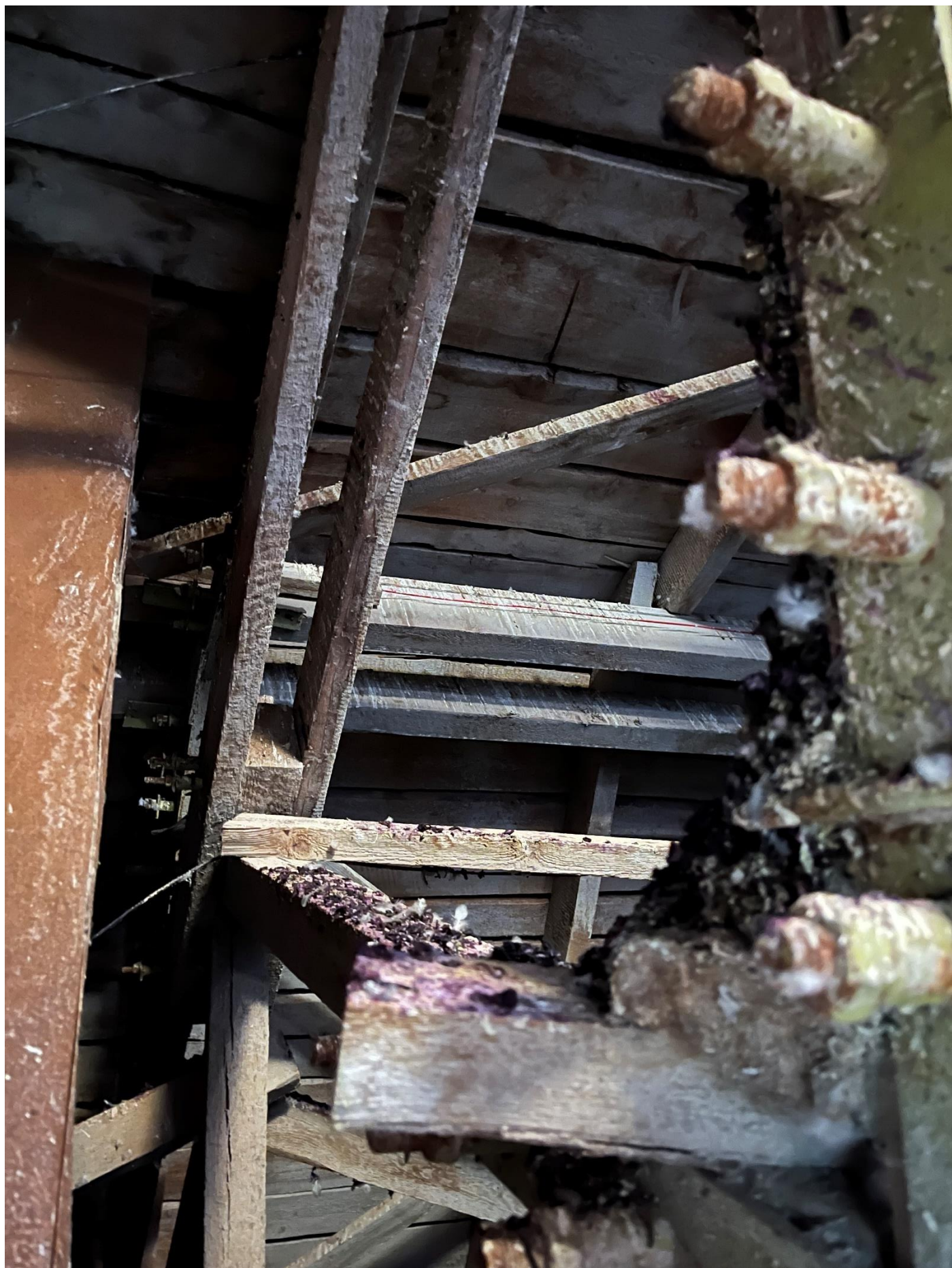
Изображение 39. Продольные трещины на стойках стропильной системы
