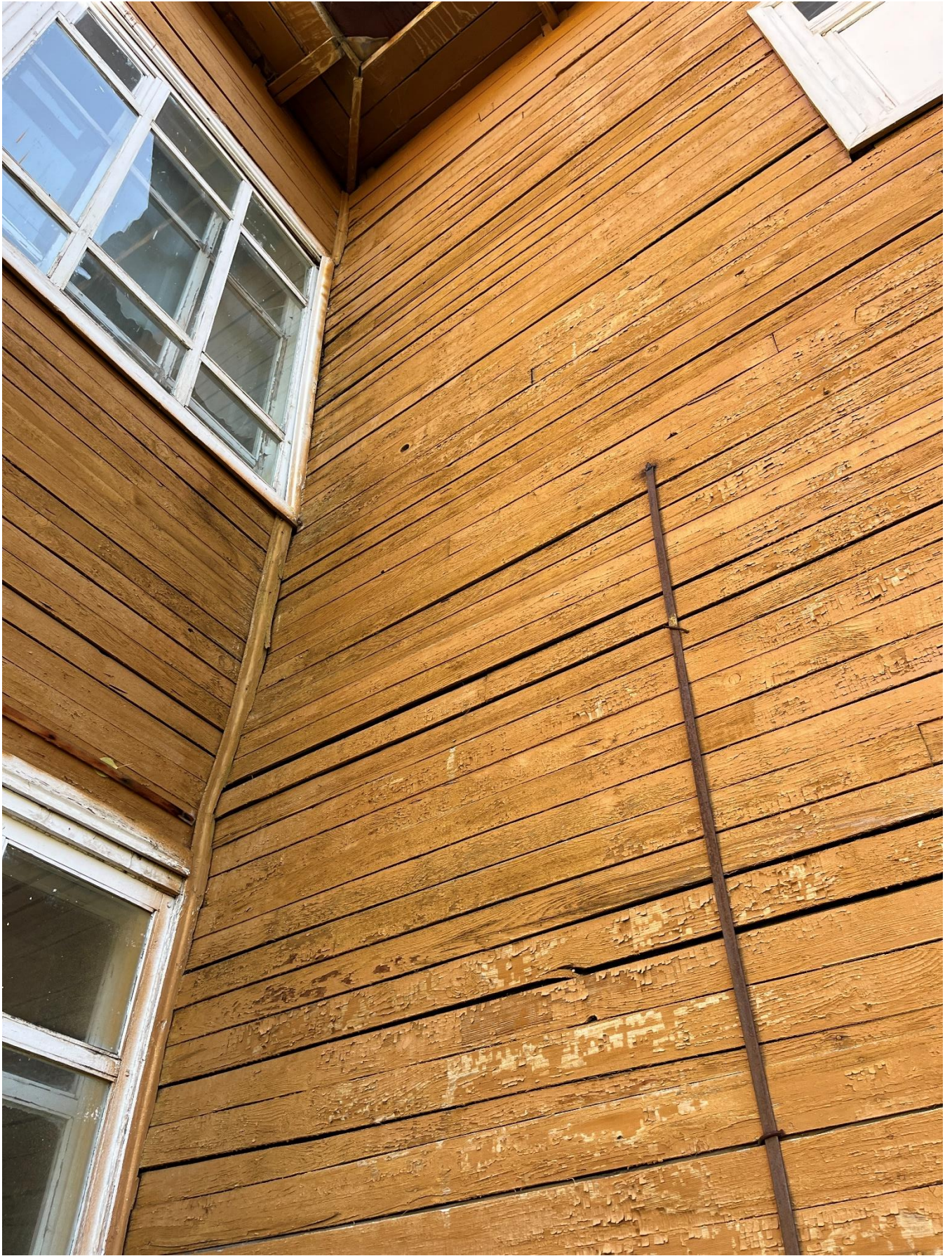
Изображение 21. Выпучивание и деформация дощатой обшивки по наружным стенам
