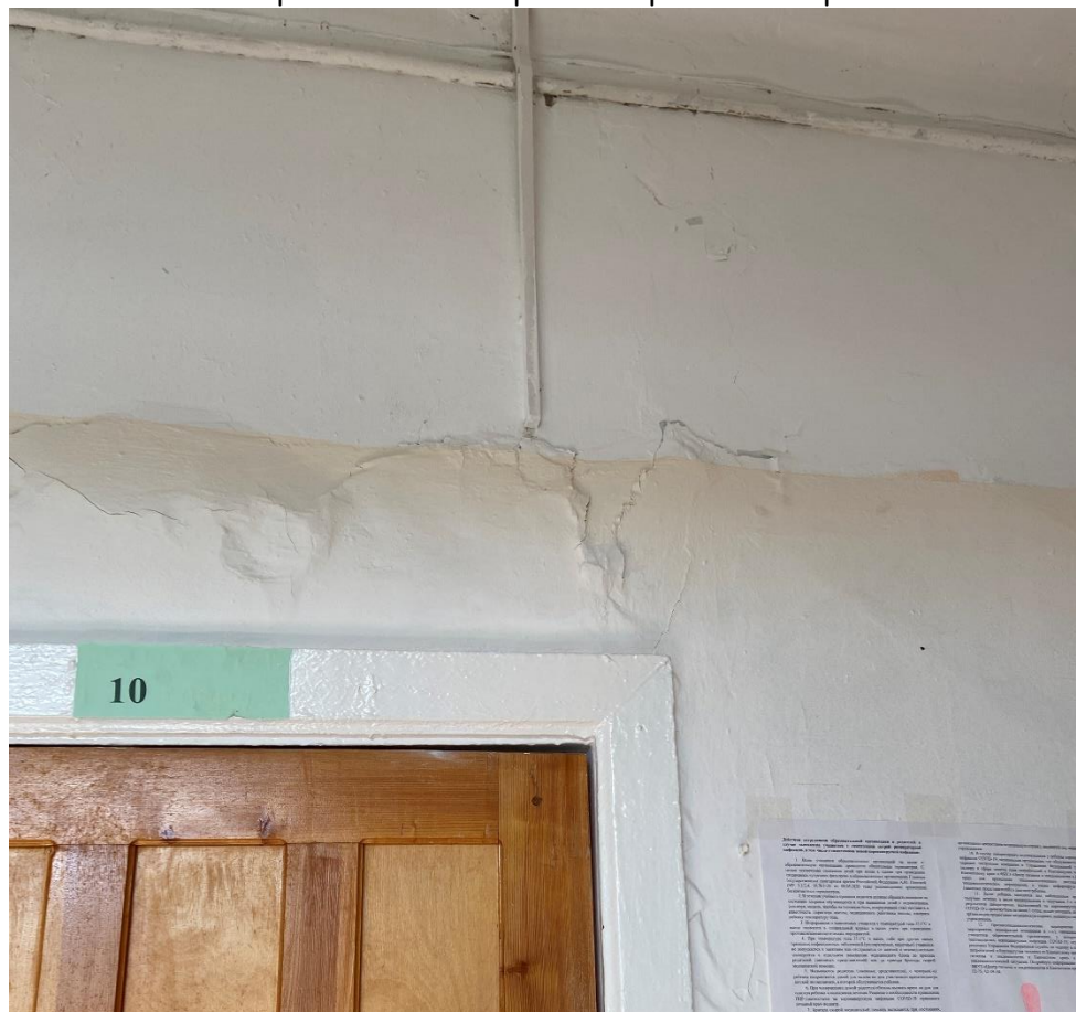
Изображение 32. Образование сет трещин по штукатурному слою стен
