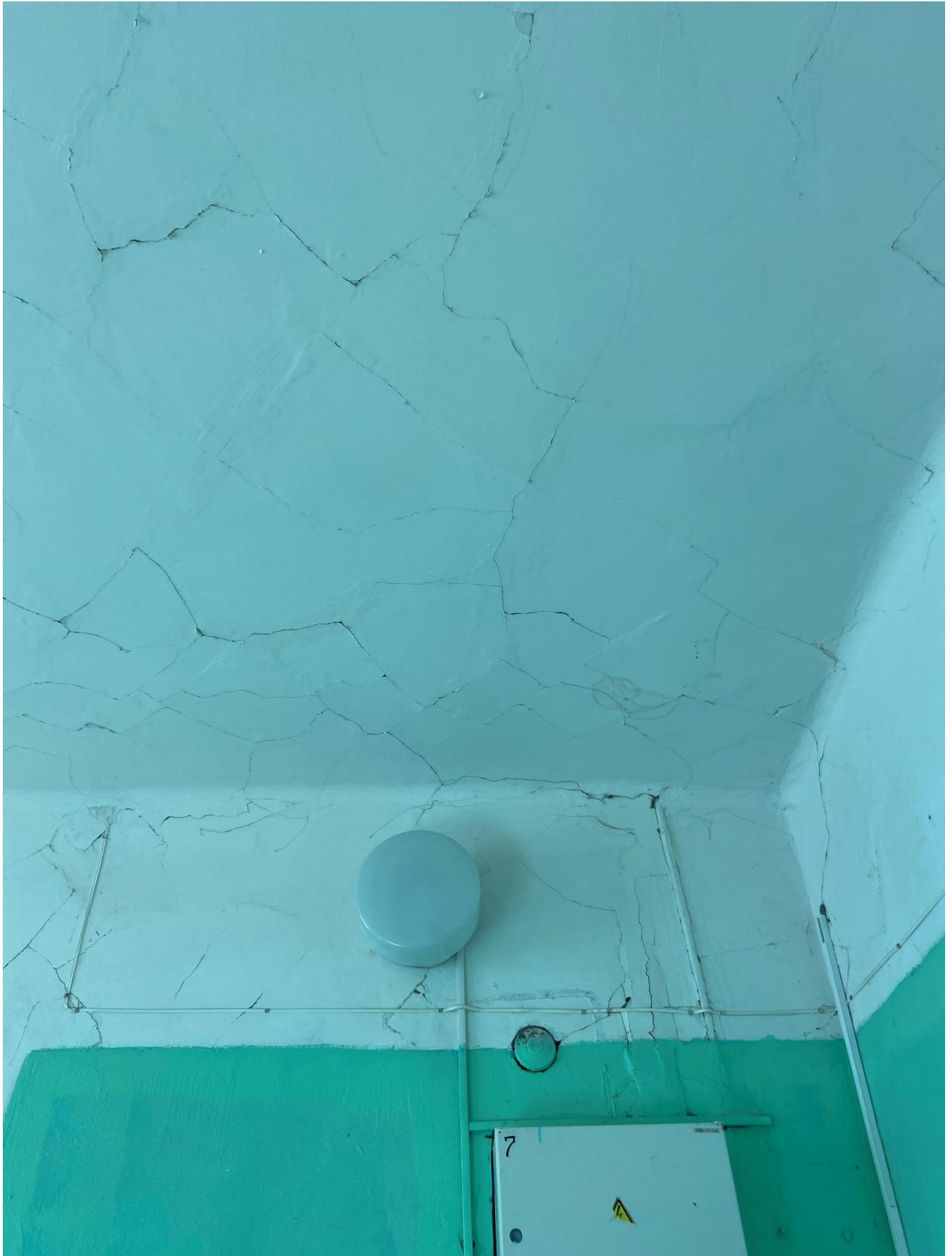
Изображение 34. Образование сети трещин по штукатурному слою стен и перекрытия
