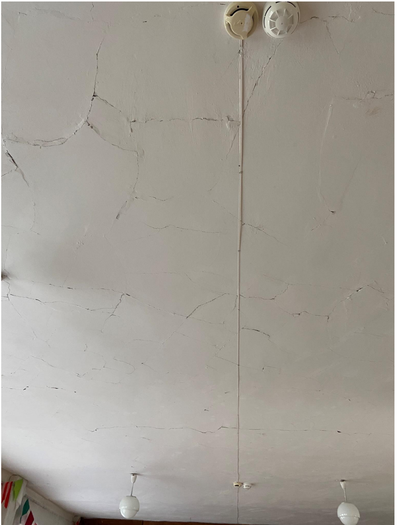
Изображение 30. Образование сети трещин по штукатурному слою перекрытия
