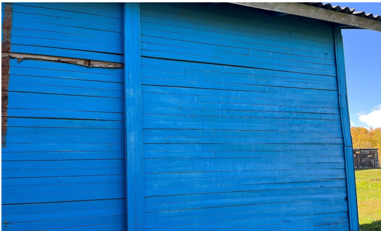
Изображение 20. Деформация наружной дощатой обшивки стен здания
