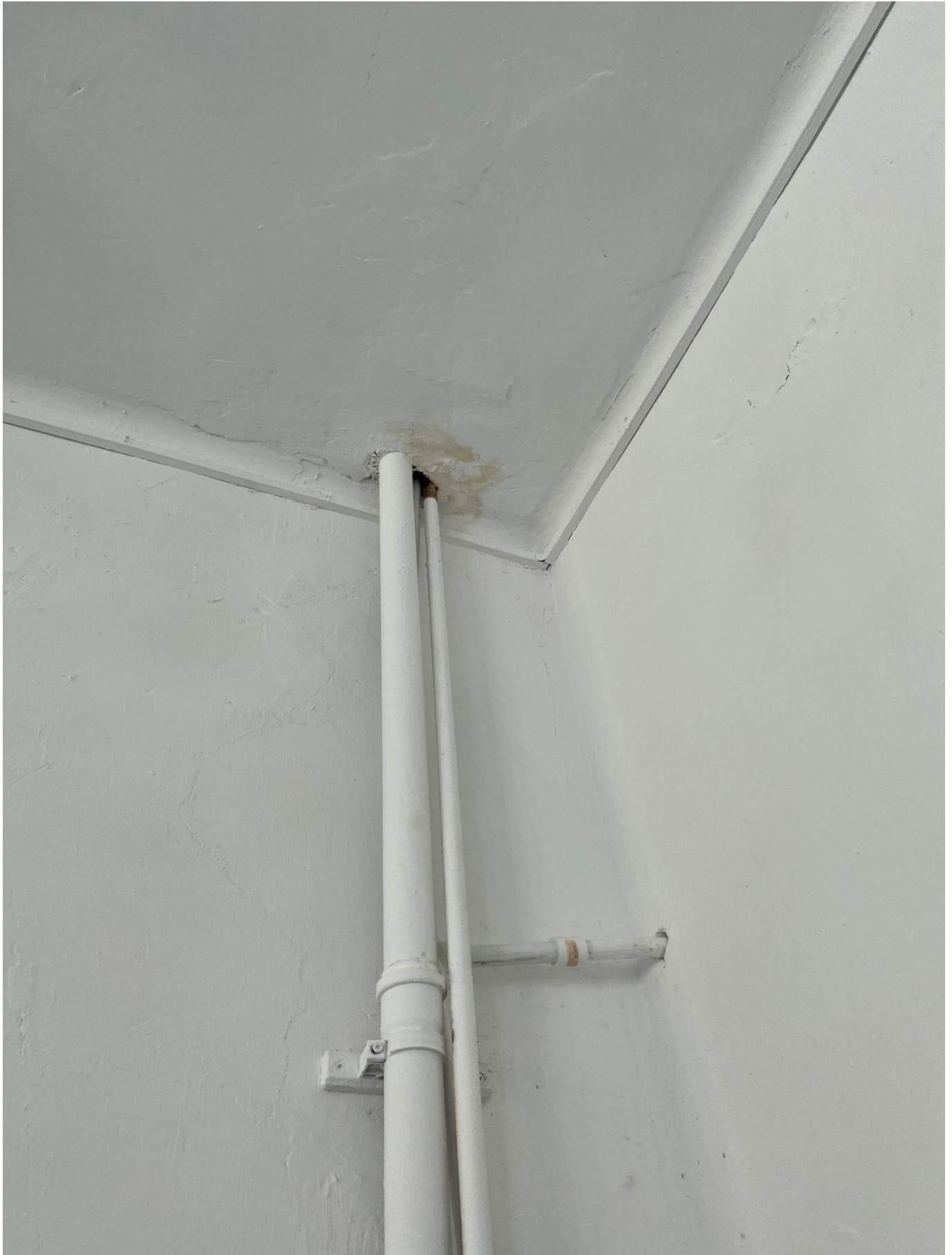
Изображение 35. Следы протечек труб водоснабжения и канализации
