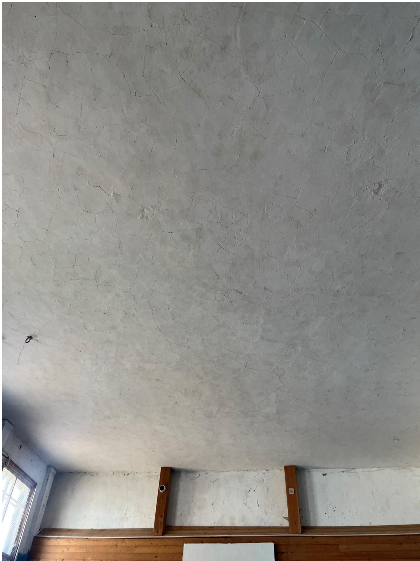
Изображение 29. Образование сети трещин по штукатурному слою стен и перекрытий
