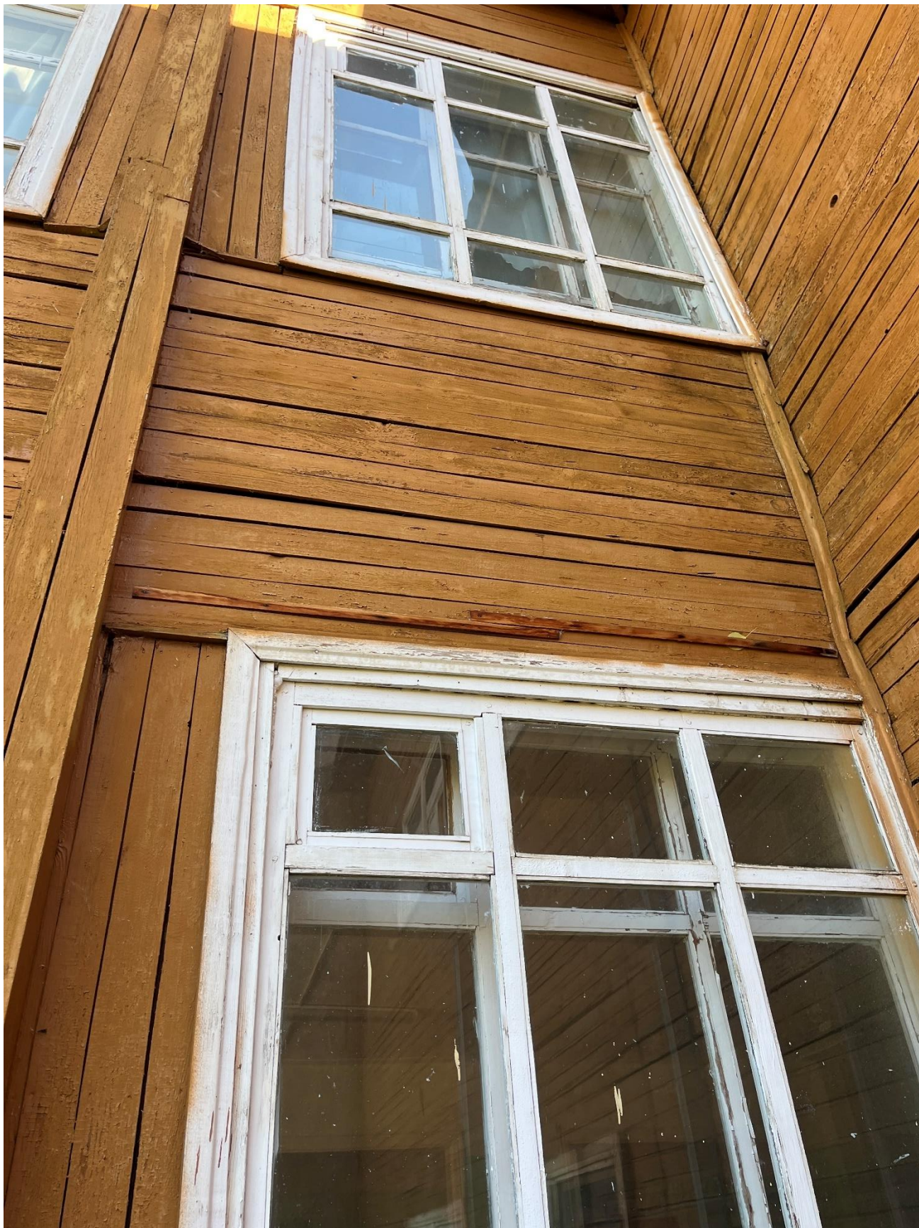
Изображение 22. Деформация и выпучивание дощатой обшивки по наружным стенам
