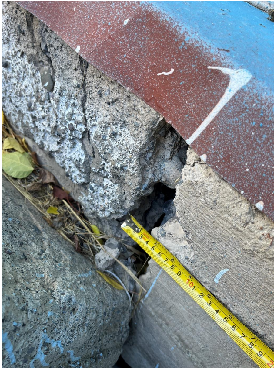
Изображение 15. Образование поперечной трещины в цоколе с шириной раскрытия более 4 см
