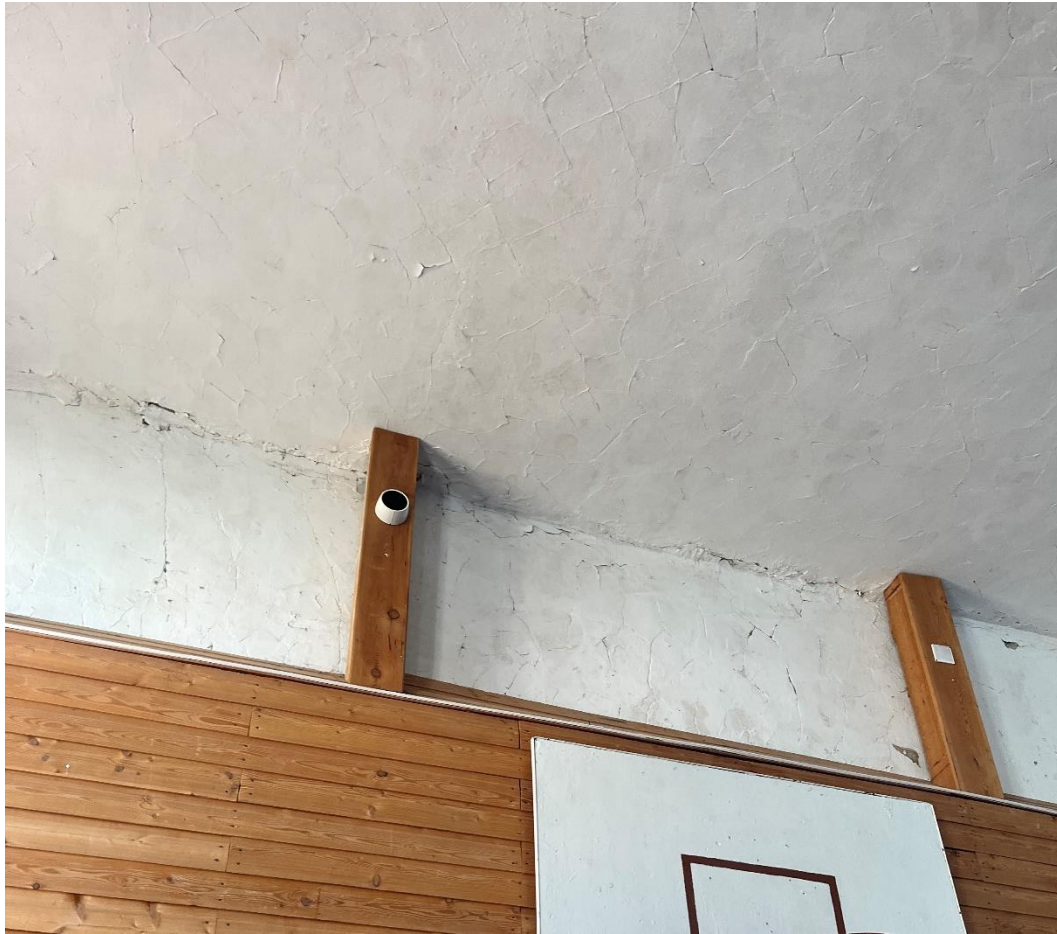
Изображение 27. Образование трещин по штукатурному слою стен и перекрытия
